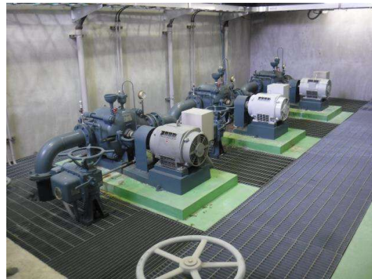
【第2浄水場 送水ポンプ】
