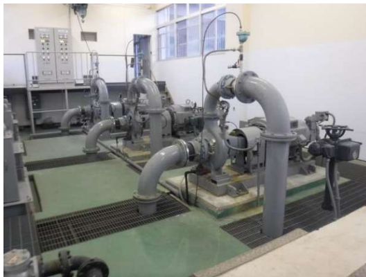
【第1浄水場 送水ポンプ】
