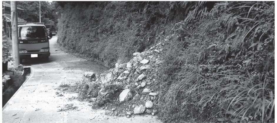
（写真 岩田田熊地区の町道への土砂崩れ）
